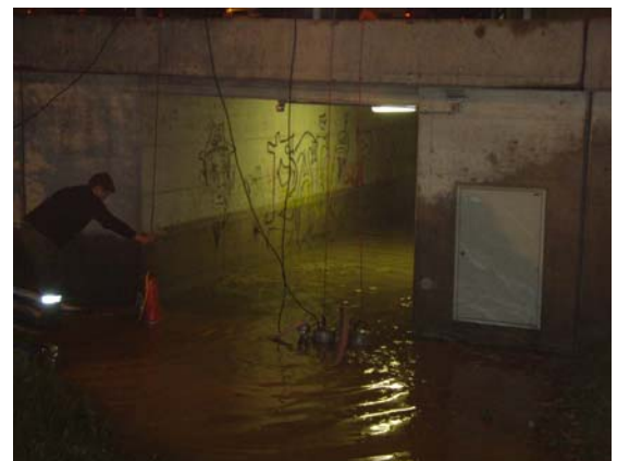
Fußgeherunterführung Heuberg: Mehr als ein Meter Wasser muss ausgepumpt werden
